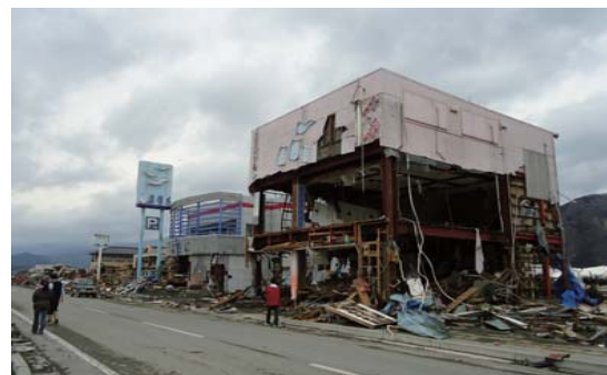
津波によって甚大な被害をうけた同胞店舗
